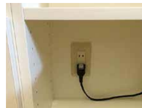
89. コンセント開口
